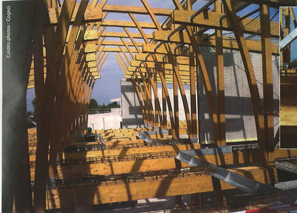
Les planchers sont constitués de dalles de béton armé coulé en place et connectées aux poutres en bois au moyen de tire-fonds métalliques. Ce système améliore l'acoustique et la rigidité.
